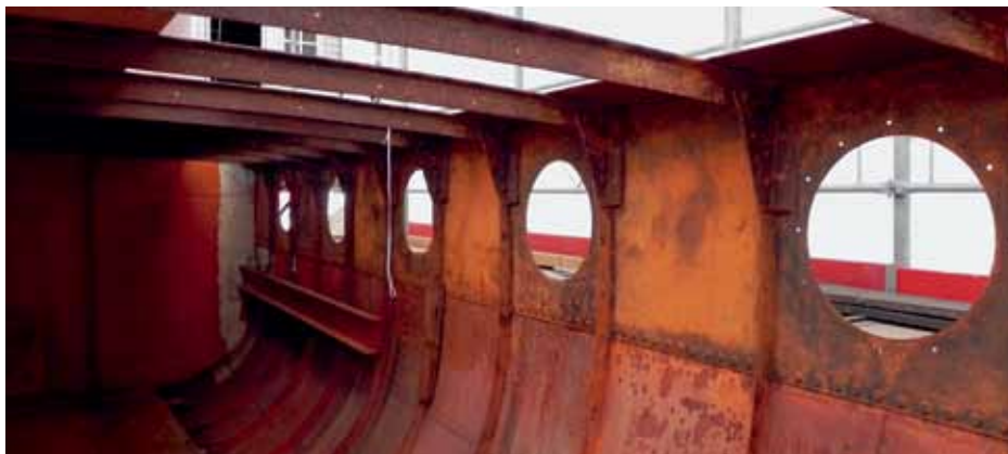
Die Arbeiten am DS «Rigi» im Verkehrshaus sind auf Kurs. Aktuell unterstützte eine Berufsschulklasse aus dem Kanton Aargau die Wiederherstellungsarbeiten während drei Tagen.
